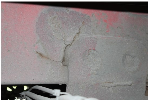
Risse am Fahrzeugrahmen sind erhebliche Mängel.
